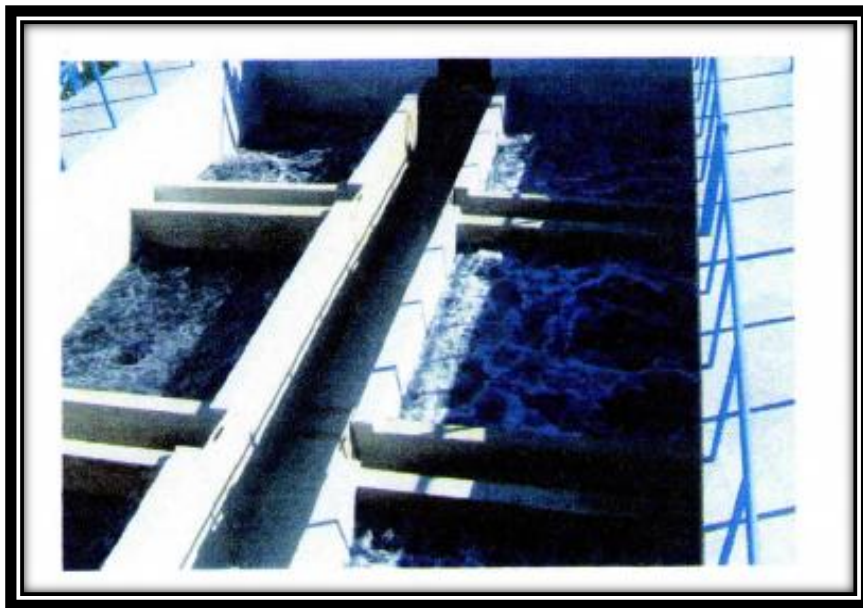
Figure (IV-8) : Nettoyage des filtres.
