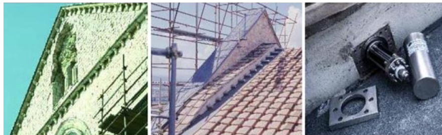
Figure 3.8 : Basilique Saint François à Assise en Italie, modernisation du tympan endommagé par l'introduction de trois groupes d'actionneurs en AMF (Pampanin, 2006).
