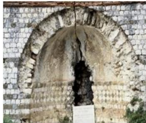
d) Arcade centrale, niche endommagée
