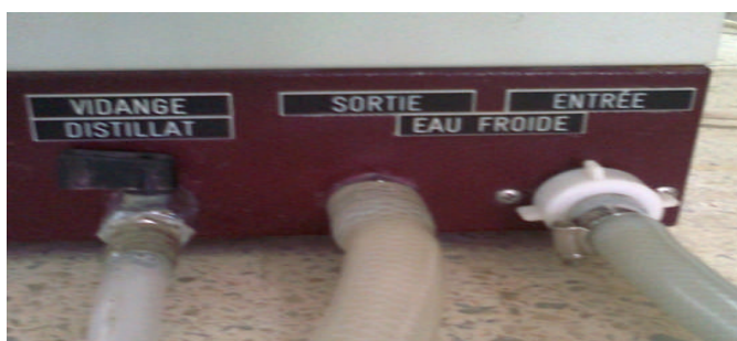
Figure III.5 : Vidange et sortie d'eau de refroidissement
