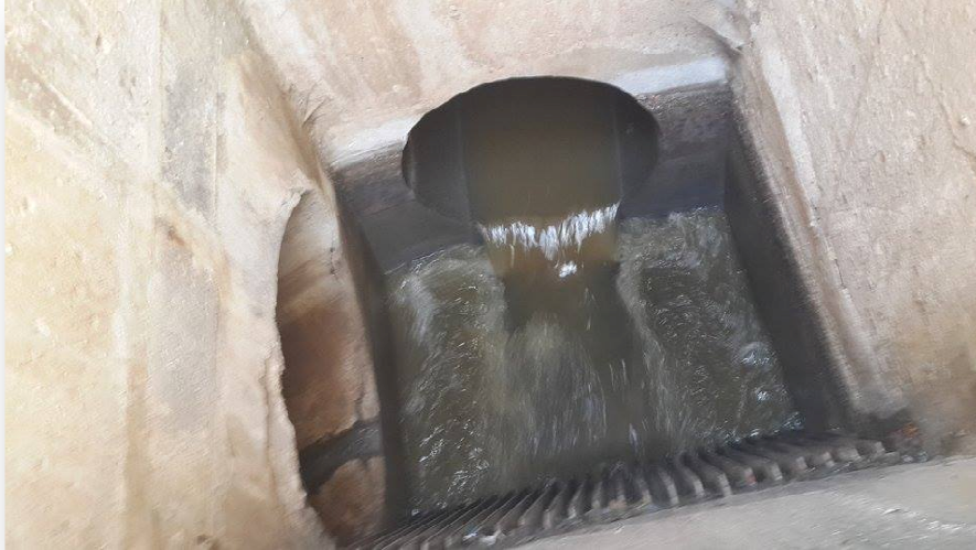
Photo II-3 : Déversoir d'orage (T.ILYES, A.DERAR, photos prises au site, STEP de sidi bel abbes, 2014).
