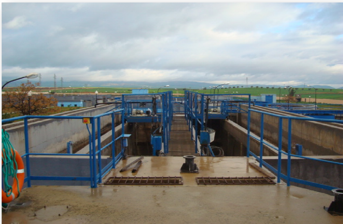
Photo II -8 : Le dégraissage-déshuilage (TALEB.I, AHMED BRAHIM.D, photos prises au site, STEP de sidi bel abbes, 2014).
