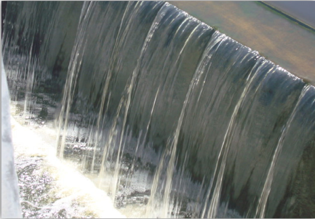
Photo II -18 : Bassin de chloration (TALEB.I, AHMED BRAHIM.D, photos prises au site, STEP de sidi bel abbes, 2014).
