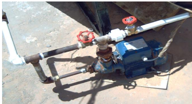
Figure IV-15: La pompe de circulation installée au niveau du circuit hydraulique pour homogénéiser la température de l'eau à l'intérieur du capteur-stockeur
