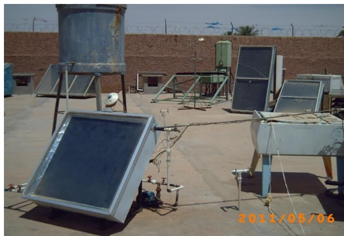
Figure IV-9: Photo montrant le banc d'essai expérimental du chauffe-eau capteur-stockeur installé sur la plate-forme des essais de l'URER/MS
