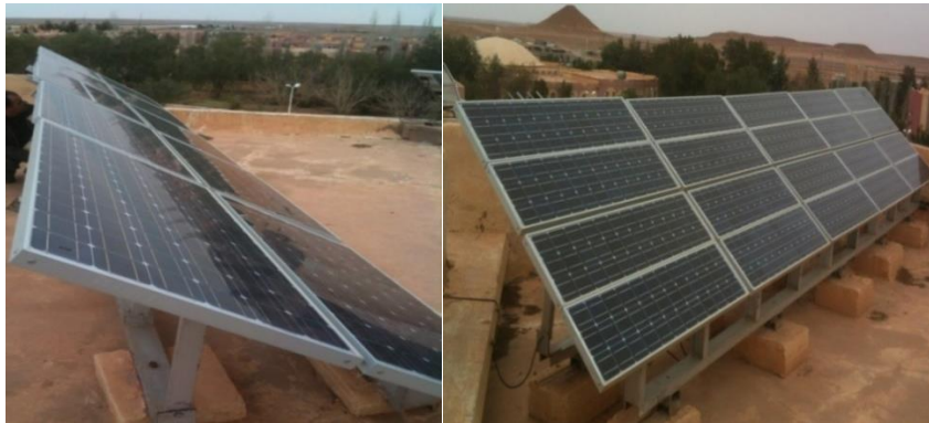
Figure IV. 13 Les deux mini centrales 1) à base de module I-100/24 ; 2) à base de module I-50.
