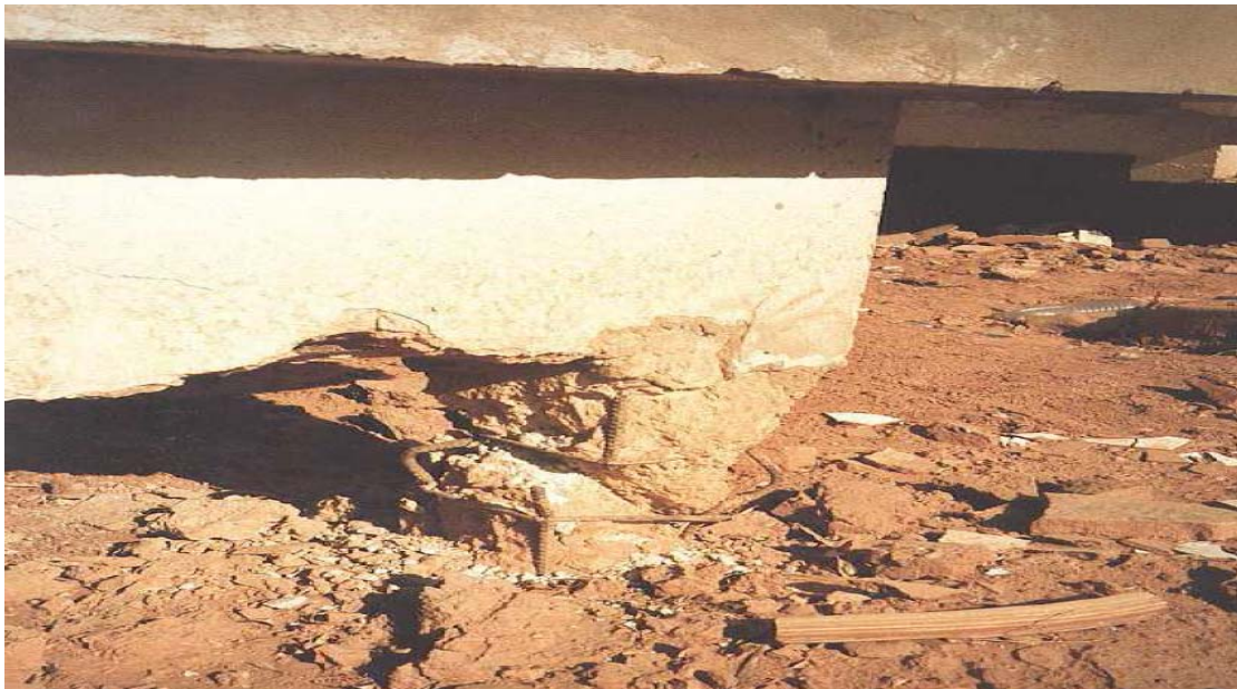
Figure 1.9 : Cisaillement au niveau des nœuds (Derriche et al.) (Cité par DJAANI et BENMANSOUR, 2011, Stabilisation des sols gonflants de la région d'In-Aménas par ajouts des liants hydrauliques (Chaux et Ciment)).
