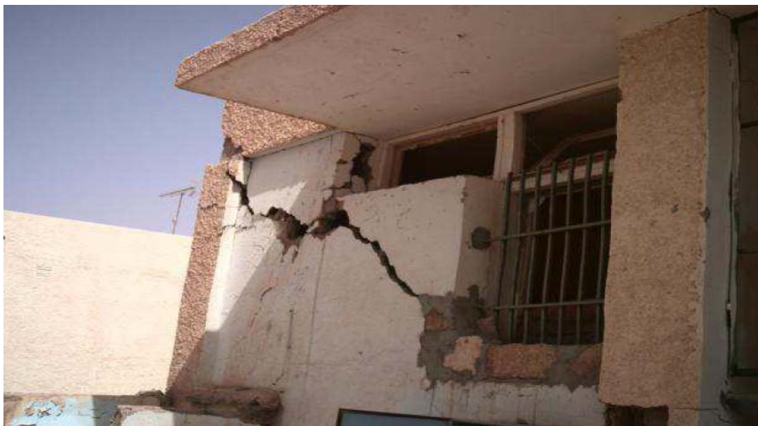
Figure 1.7 : Fissure sur les murs (Zenkhrri, 2010).
