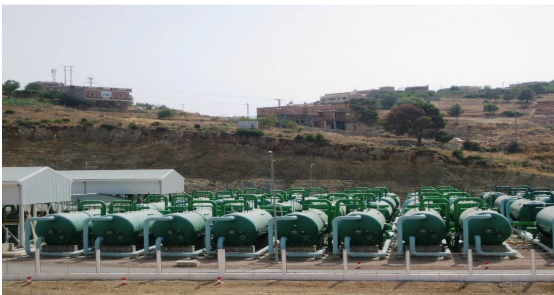
Photo IV.4 : Les filtres à sable
