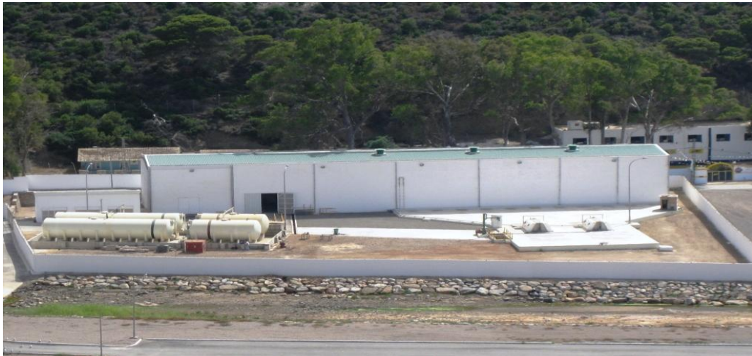
Photo IV.3 : Le captage de l'eau de mer
