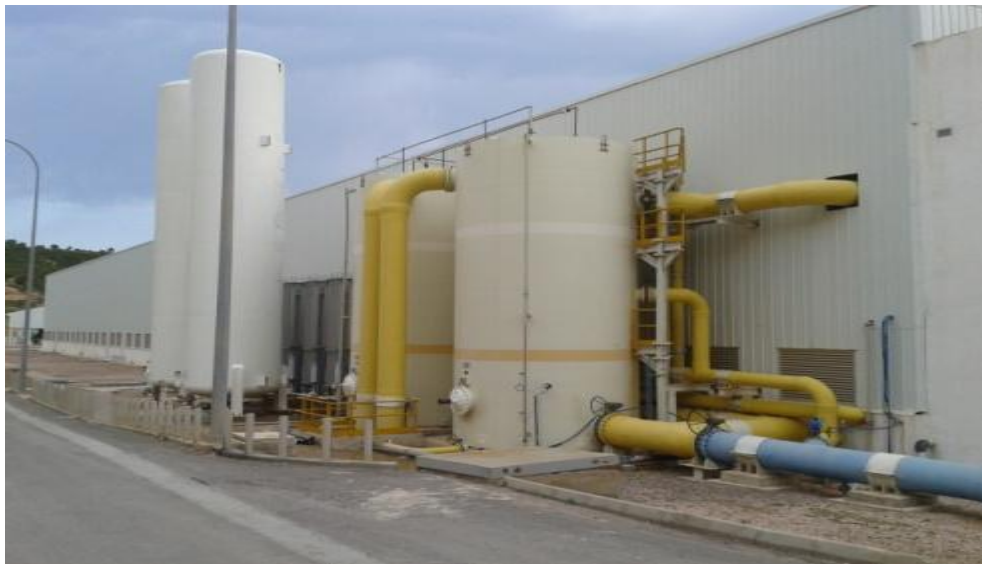
Photo IV.7 : Les réservoirs de CO 2 (Station de Dessalement-Honaine)
