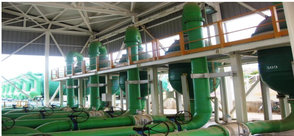
Photo IV.5 : Les filtres à cartouche
