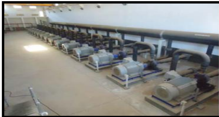
Figure IV.11: Station de pompage de l'eau traitée.
