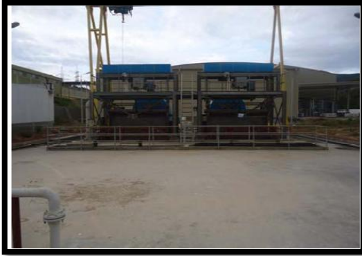
Figure IV.3: Le gros dégrilleur.
