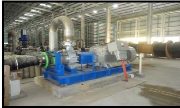
Figure IV.6 : Pompe à haute pression.
