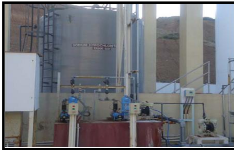
Figure IV.8 : Réservoir d'hypochlorite de sodium utilisé pour la désinfection finale.
