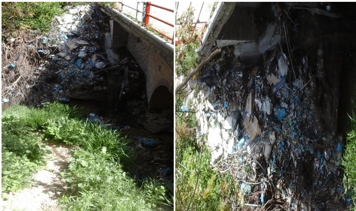
Figure VI.4. Les rejets solides déversés dans oued Hennaya (Photos « 30/03/2015 » de rond point d'Hennaya)
