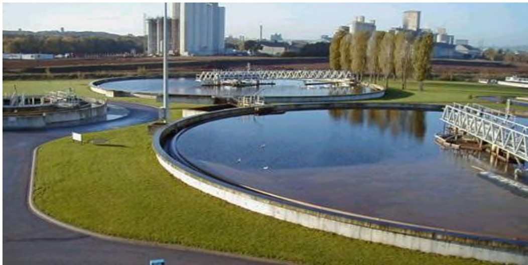
Figure I.10: décanteur secondaire «clarificateur»
