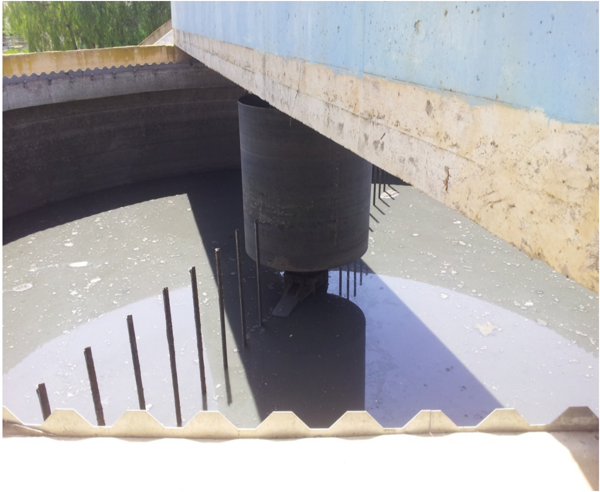
Figure II.14. Epaisseur de boue.
