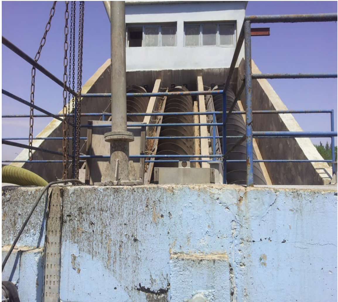
Figure II.12 : vis de recirculation de boue.
