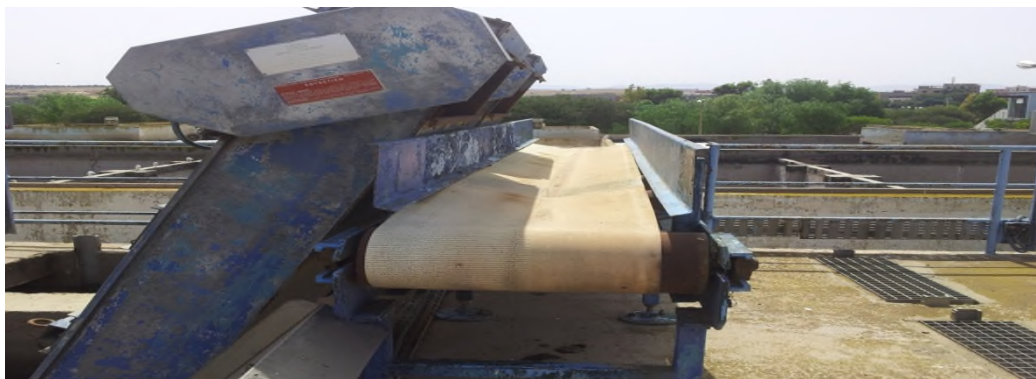
Figure II.7: la bande de transport des refus de dégrillage.
