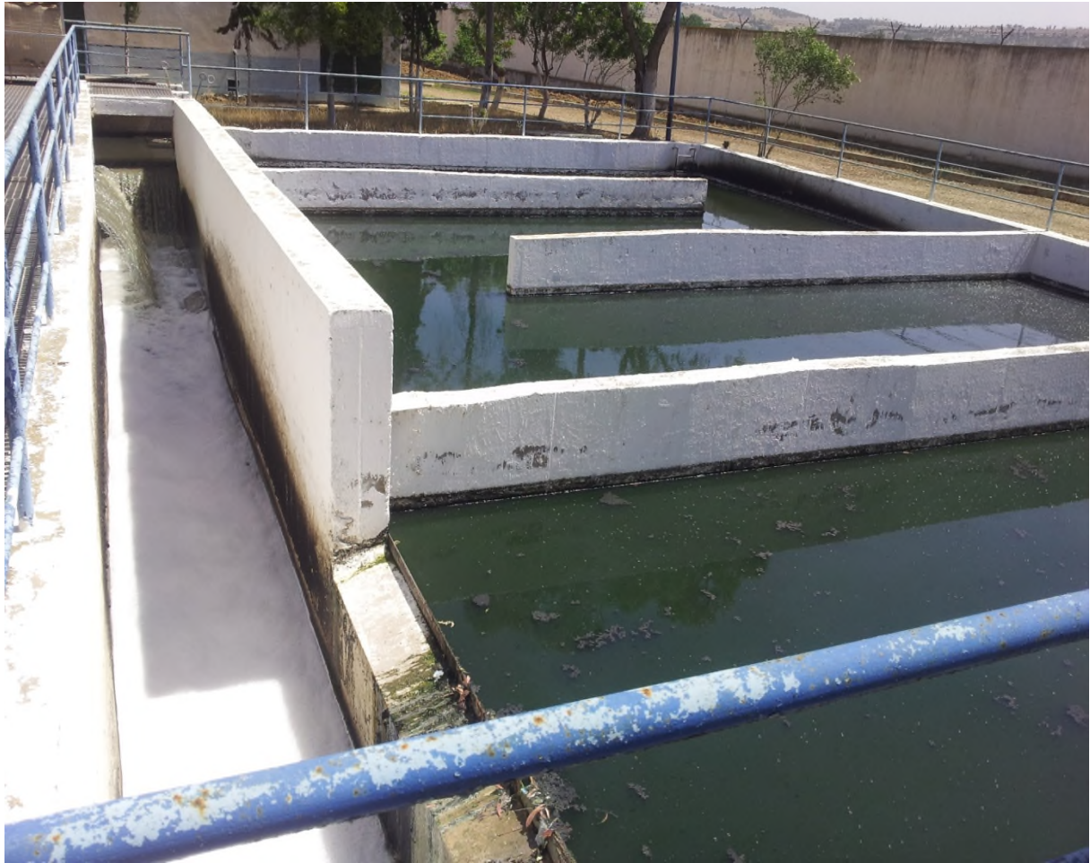
Figure II.13: Canal déversoir du rejet du bassin de chloration.
