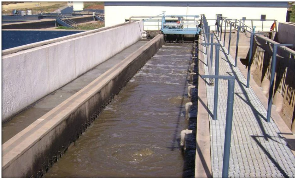
Figure III.6 : Photo du dessableur- déshuileur
