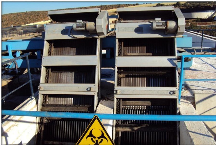
Figure III.5: Photo de la grille mécanisée
