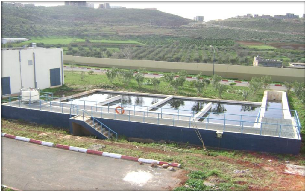
Figure III.10 : Photo du bassin de chloration
