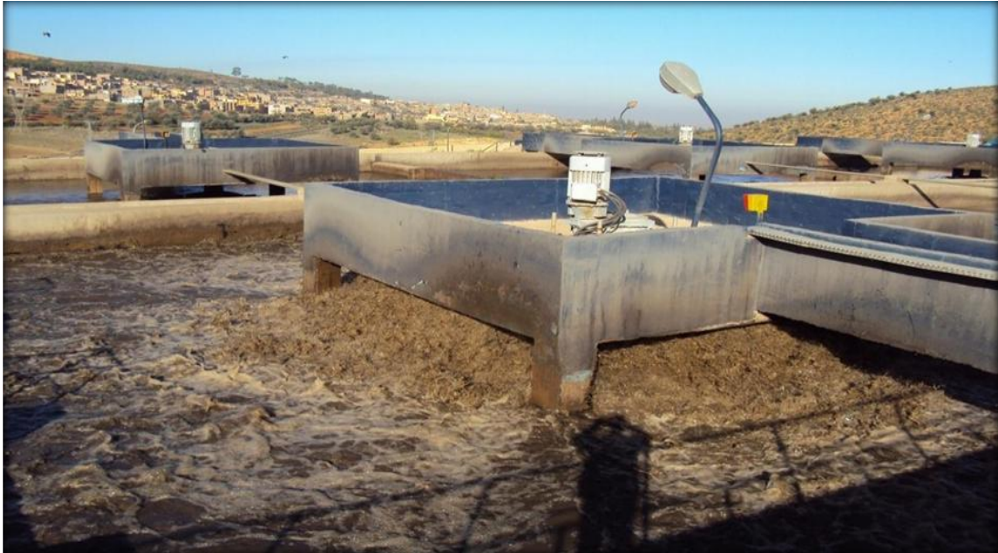
Figure III.7 : Photo du bassin d'aération
