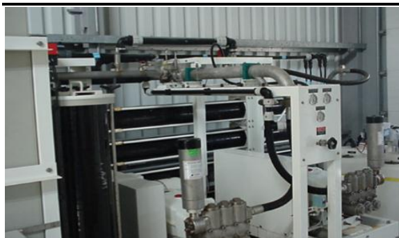
Figure III.6 : Osmoseur.SSH62-928 équipé d'un turbo
