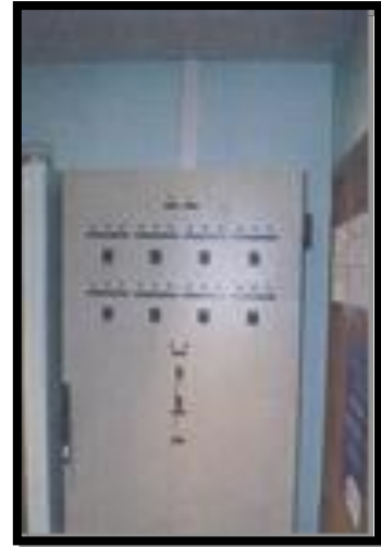
Figure153 : Centrale de détection d'incendie et pneumatique
