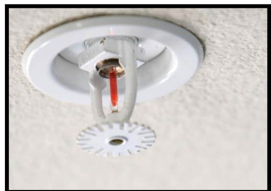
Figure 162 : Un extincteur automatique
