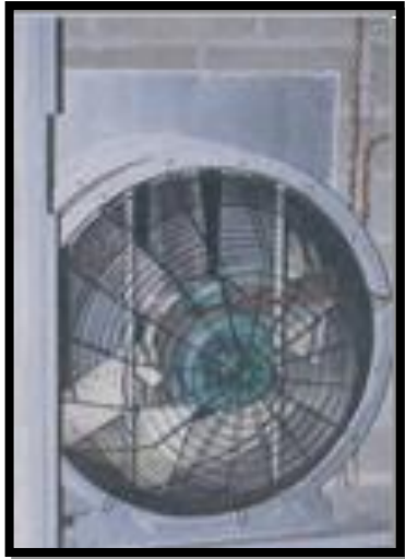
Figure 152 : Ventilateur de soufflage et d'extraction
