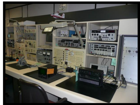
Figure 100 : Laboratoire de télécommunication
