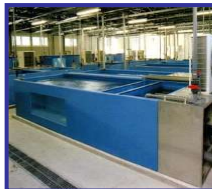
Figure 107 : Salle de filtration de l'eau
