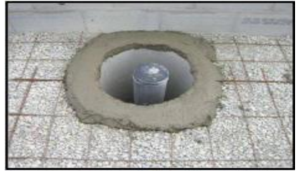
Photo 63: Une bouche d'aspiration de l'air.
