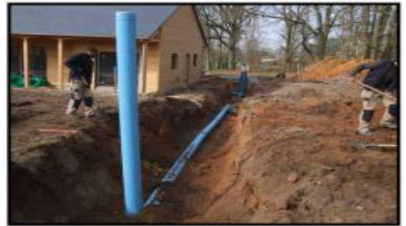
Photo 64: Des conduits pour le passage de l'air.
