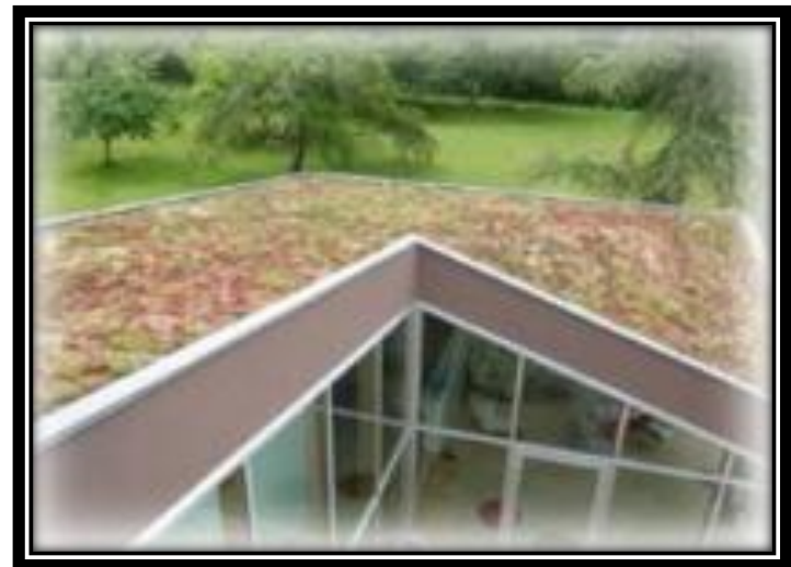
photo 11 : L'utilisation des toitures végétalises
