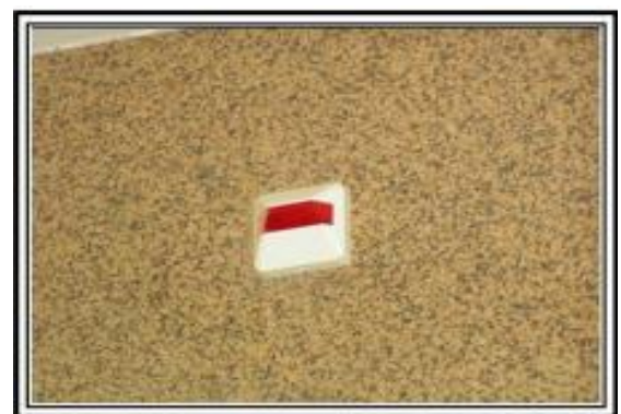
Photo 74: la signalisation des incendies.
