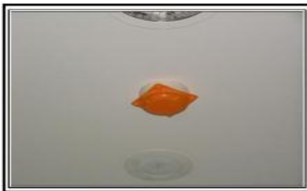
Photo 73 : L'éclairage de signalisation des issues de secours
