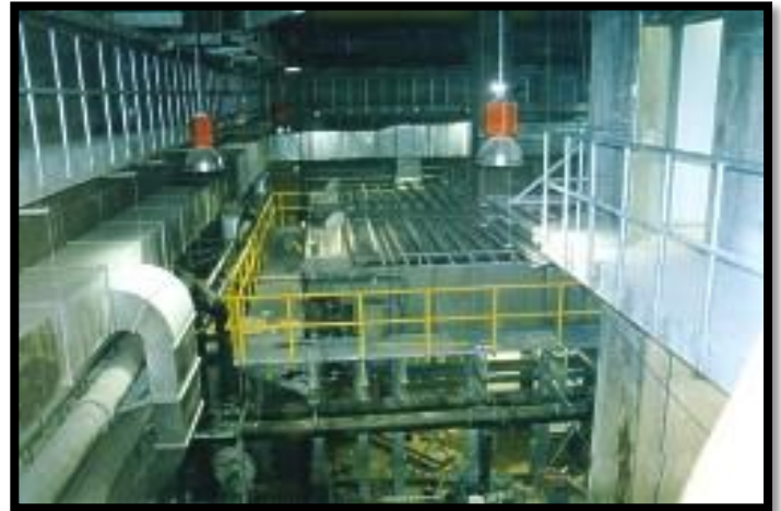
Figure 25. Traitement des eaux usées
