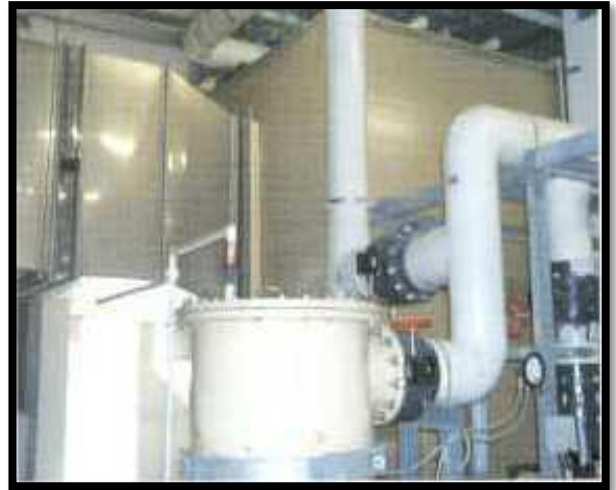
Figure 27. Épurateur de l'eau pour réduire les odeurs
