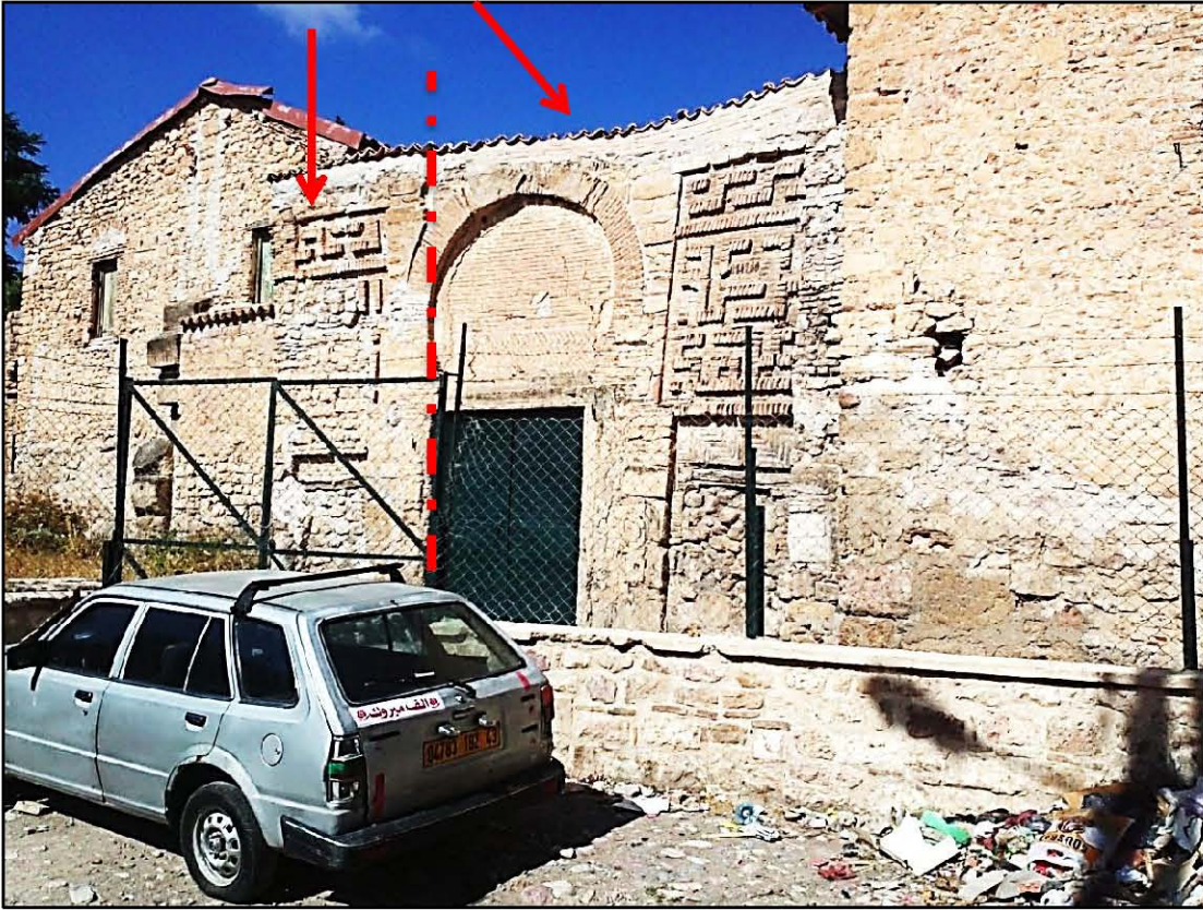
صورة رقم (1): تبين الواجهة الشرقية لمسجد أبو المهاجر وميلها نحو الداخل
