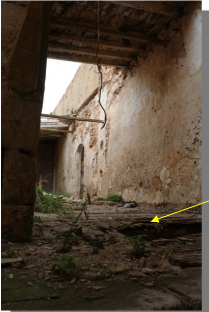
الصورة رقم: 106 تشقق الجدار بسبب الفطريات وجذور النباتات.
