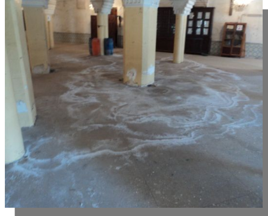
الصورة رقم: 71 تجمع الأملاح في أرضية بيت الصلاة.
