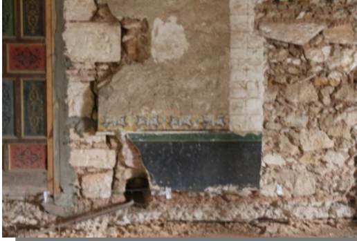
الصورة رقم: 78 تآكل مواد البناء
