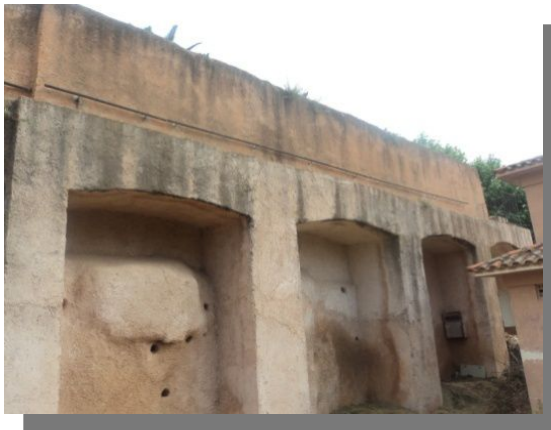
الصورة رقم: 27 ارتفاع نسبة الرطوبة في قواعد
