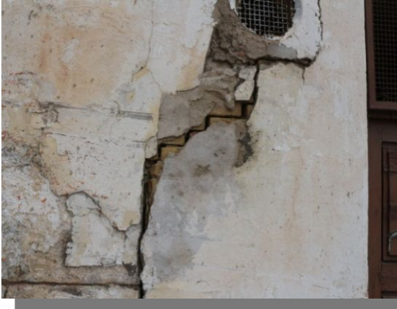
الصورة رقم: 72 تصدع الجدران.
