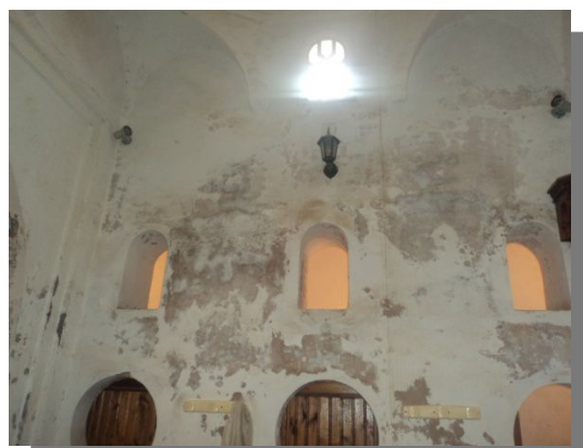
الصورة رقم: 57 ارتفاع نسبة الرطوبة في الجدران.
