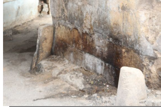
الصورة رقم: 130 تبقع الجدران واتساعها.
