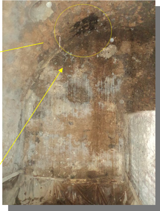
الصورة رقم: 01 سيلان مياه الصرف على الجدران.
