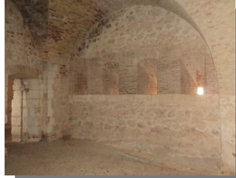
الصورة رقم: 123 ارتفاع الرطوبة بالخاصية الشعرية في الجدران.
