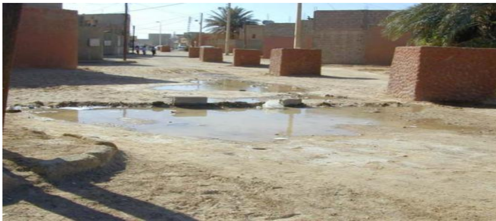
(c)- Fuite proche d'une foggara
