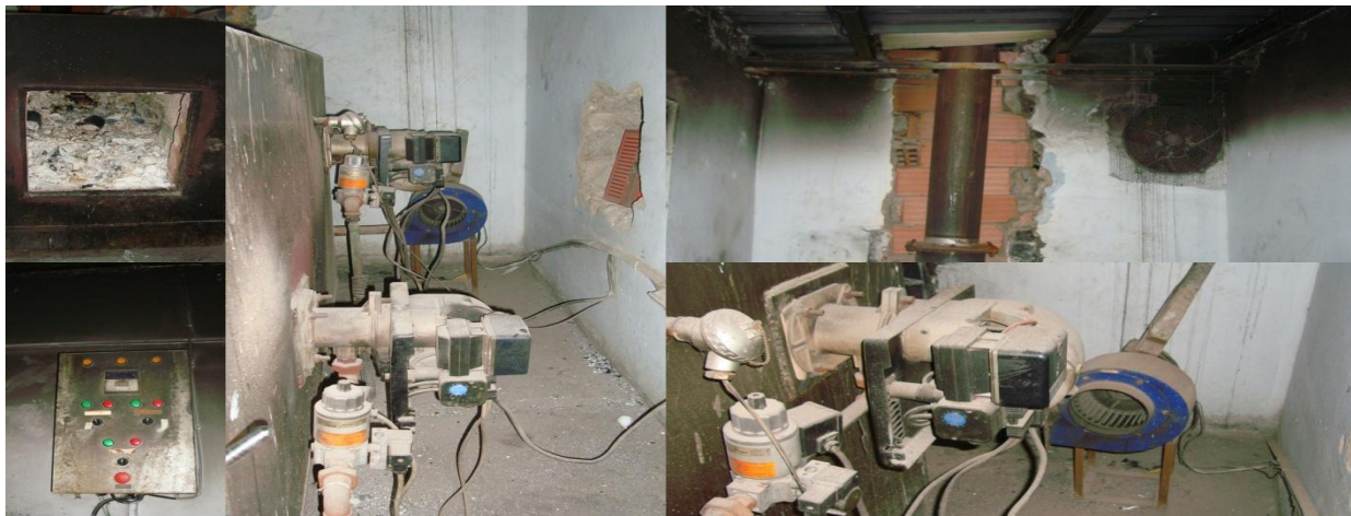
Photo 7 : Incinérateur de l'EPSP
