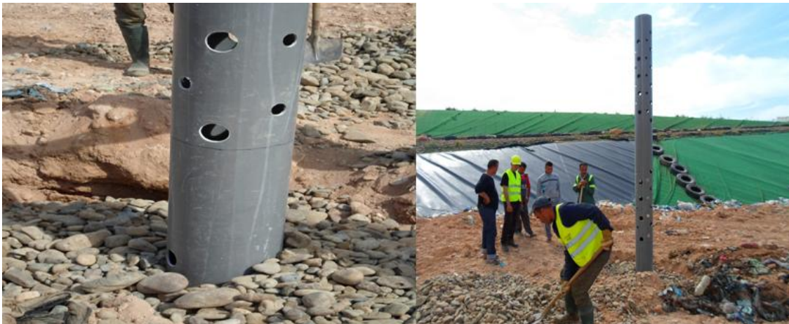
Figure 17 : Système récupération de biogaz.
