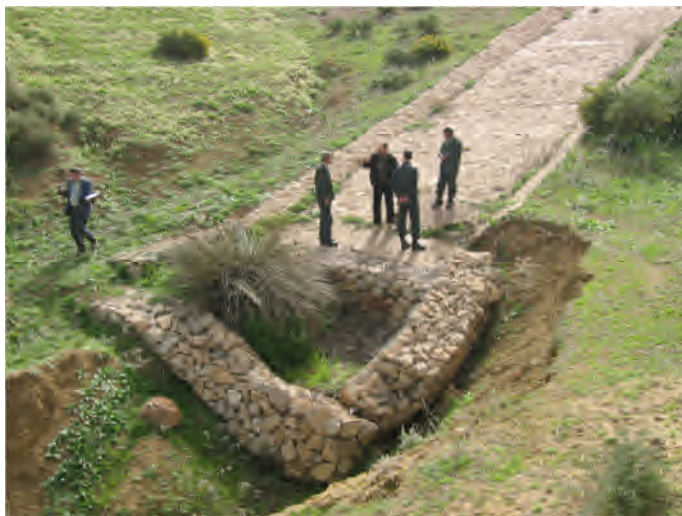
b) Seuil de correction torrentielle en terre inadapte en terrains marneux : déversoir endommagé par la force des eaux
