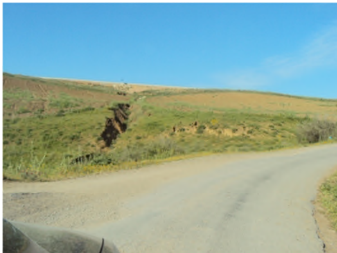
c) Erosion en ravine menaçant une route à S/A Chérif
