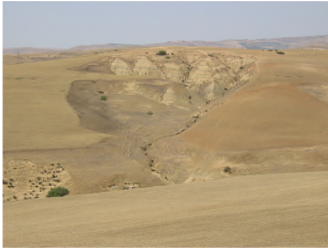
a) Ravinement en V sur formation marneuse transformant le paysage en " badlands "
