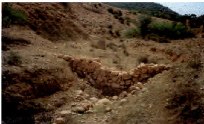
c) Seuil en pierres sèches ; La partie aval est très vulnérable à l'érosion régressive (renard)
