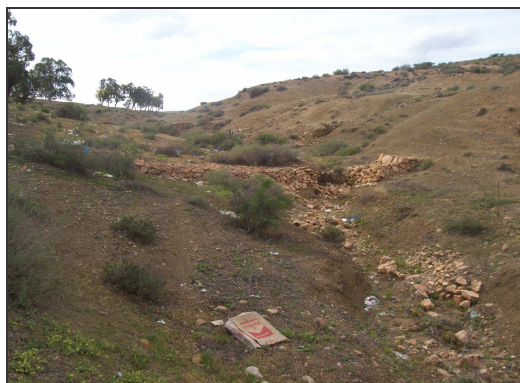
Photo n°17 : seuil en pierres sèches déstabilisé à cause d'une mauvaise fondation (Cliché Zékri et Boucif, Avril 2011)
