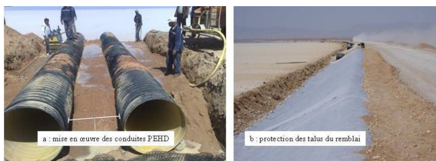
Figure12. Mise en place des conduites PEHD (a) et protection des talus (b)
