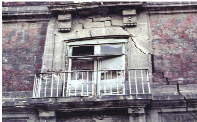
Figure 7. Edifice avec fissures provoquées par subsidence, ville Mexico
