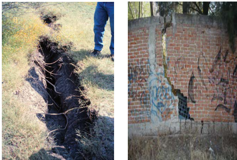
Figure 6. Rupture du sol causée par la subsidence à Guanajuato, México
