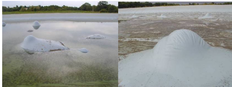
Figure 5. Endommagement de la géomembrane
