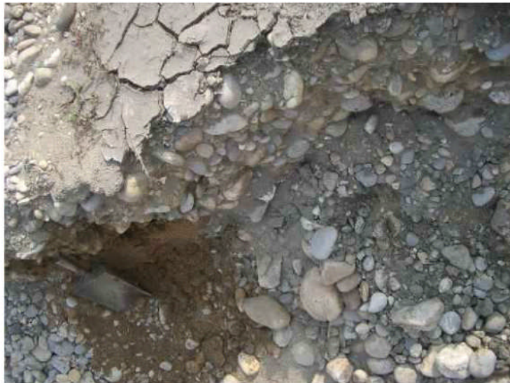
Figure 1.5. Vue de dessus du sol d'un bassin d'infiltration colmaté (cité par Alhaddad, 2011)
