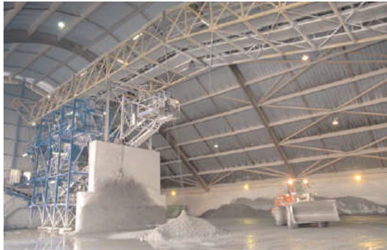
Zone de stockage des mâchefers
