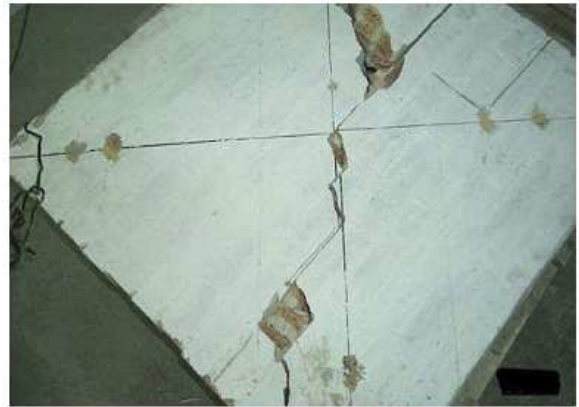
(b) Fissuration de la deuxième paroi
