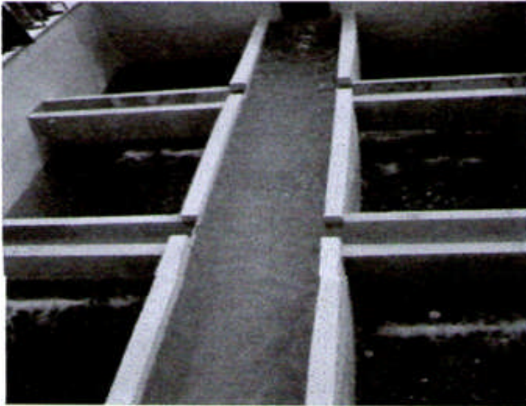
Photo II.1 : Filtres à sable rapides [33]
