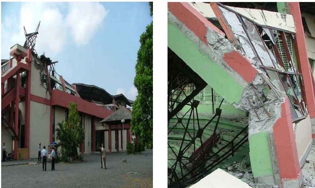
Figure 2.14 Dommages du stade GOR Sport causés par le séisme de Yogyakarta (2006) (Elnashai et al 2006)
