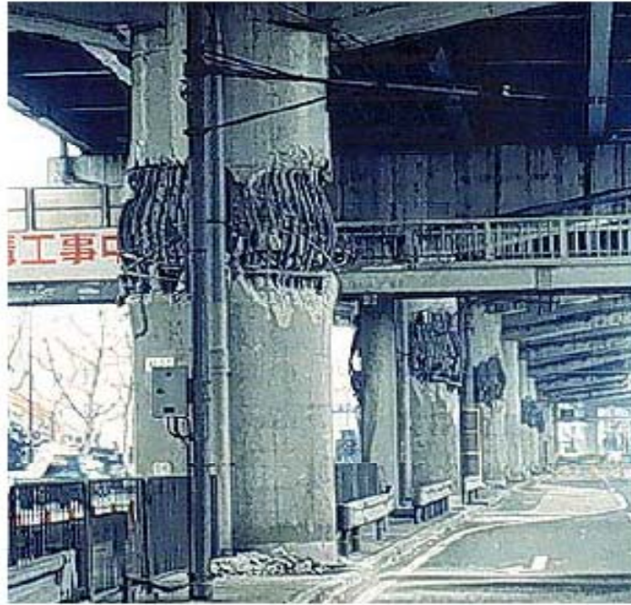
Figure 2.12 Rupture par compression d'une série de piliers de l'autoroute de Hanshin par le séisme de Kobe (1995). (Papazoglou et Elnashai 1996)
