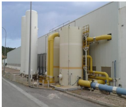
Figure n°11 : Les réservoirs de CO 2 (Station de Dessalement-Honaine)
