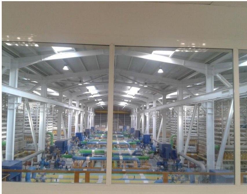
Figure n°08 : L'étape de l'osmose inverse (Station de Dessalement-Honaine)
