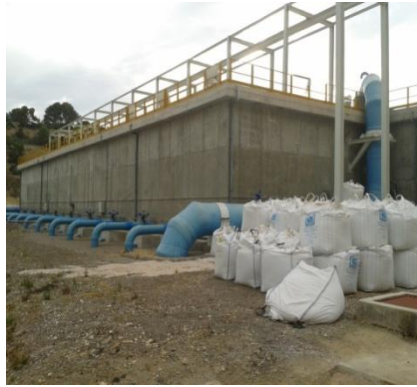
Figure n°10 : Réservoir de l'eau dessalée (Station de Dessalement-Honaine)
