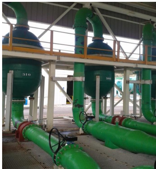
Figure n°07 : Filtres à cartouches au niveau de la station (Station de Dessalement-Honaine)
