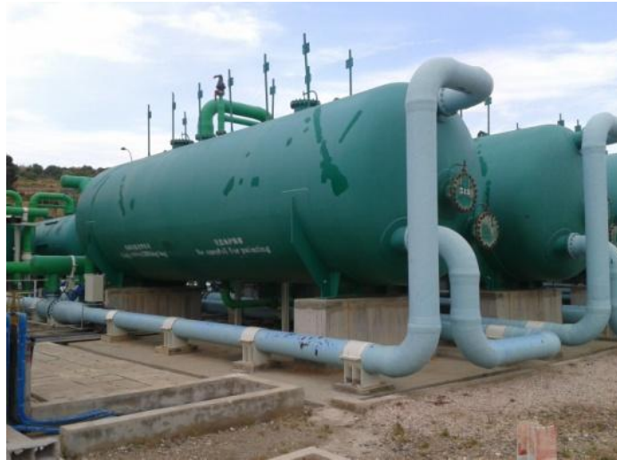
Figure n°06 : filtres à sables et anthracite (Station de Dessalement-Honaine)
