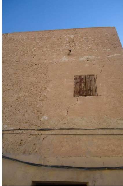
الصورة رقم (78): الميزاب وفتحة غرفة لعللي على مستوى الطابق الأول - قصر ورقلة
