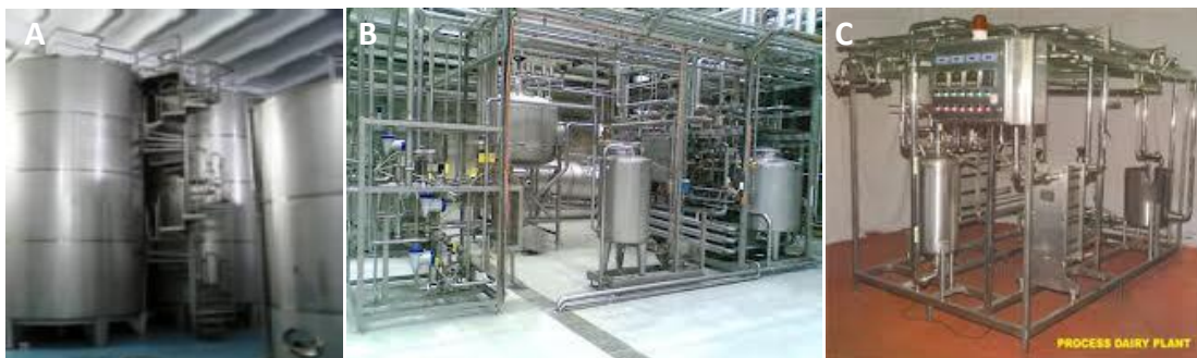
Figure 15 : Equipement laitiers. (A) : tanks de stockage du lait, (B) : système de canalisation (lactoducs), (C) : un échangeur thermique à plaque (source : internet image google)
