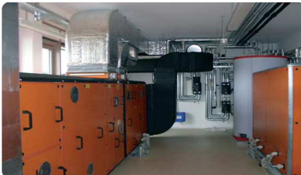
Figure IV.5 : Système utilisant un matériau déshydratant liquide installé dans le nouveau bâtiment du Centre d'Innovation Solaire (SOBIC) à Fribourg en Allemagne. [16]
