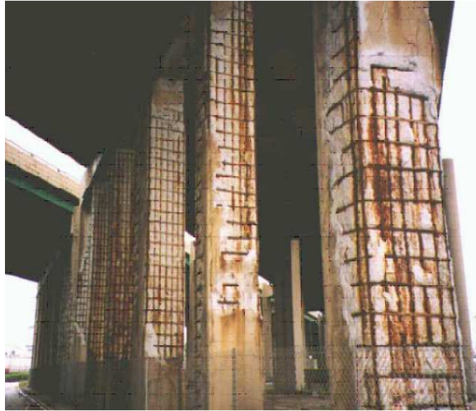
(b) Colonnes d'un pont ravagées par corrosion (France).
