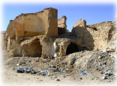
Dégradation des habitations
