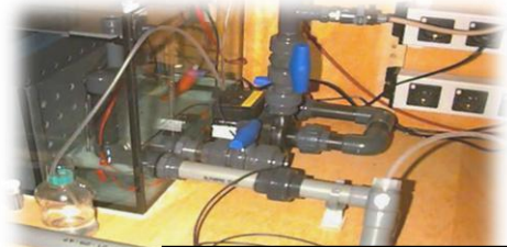
Le système de pompage
