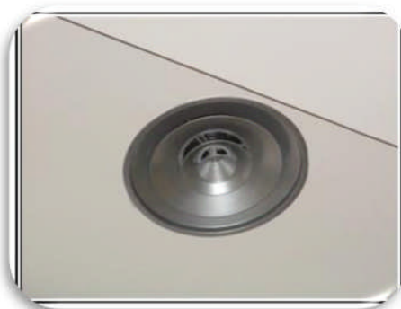
Bouches de Soufflage
