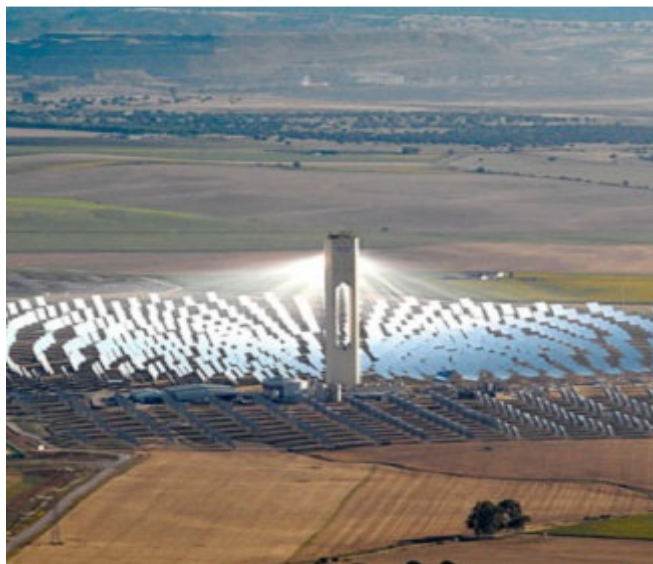
Figure II.20: Système de centrale à tour.
