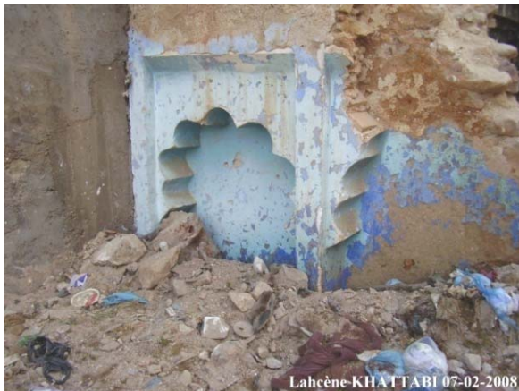
Photo 31: Une maison tombant en ruine dévoilant sa beauté et créant un espace négatif au sein de la Médina.
