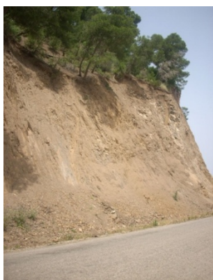
(d) Risque de glissement, RN 11, TÉNÈS, ALGÉRIE
