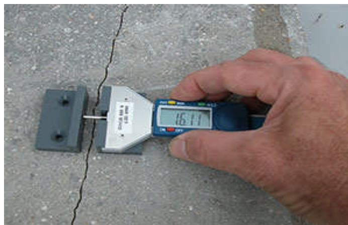
Figure 1.20 : La jauge GINGER CEBTP pour le suivi de l'évolution d'une fissure pour expertise.
