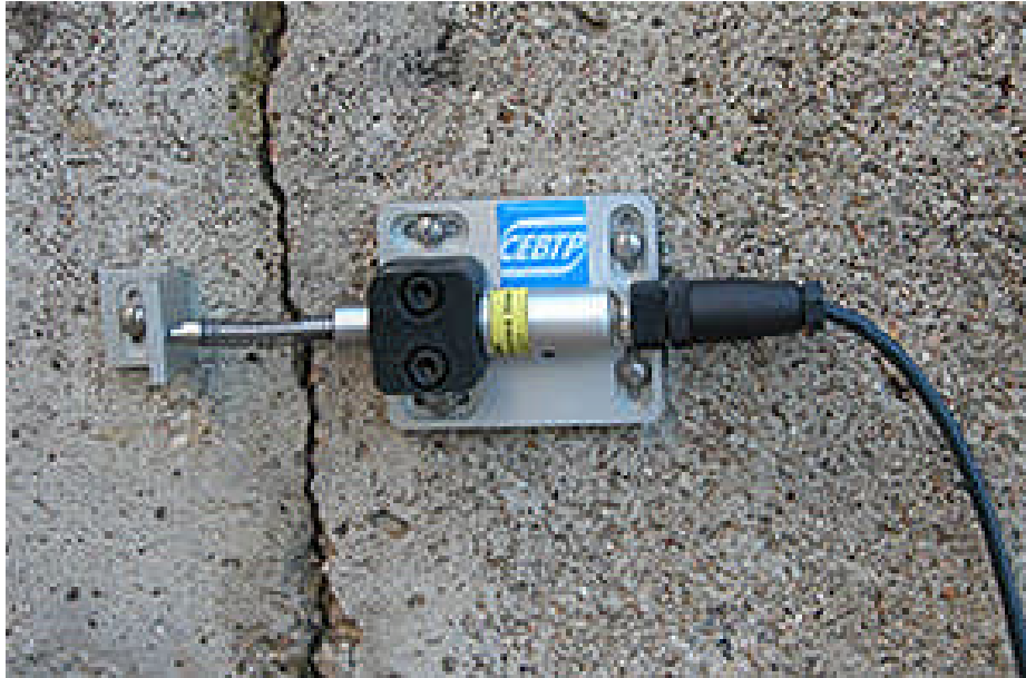
Figure 1.21 : Mesure d'évolution de la fissure avec un capteur.
