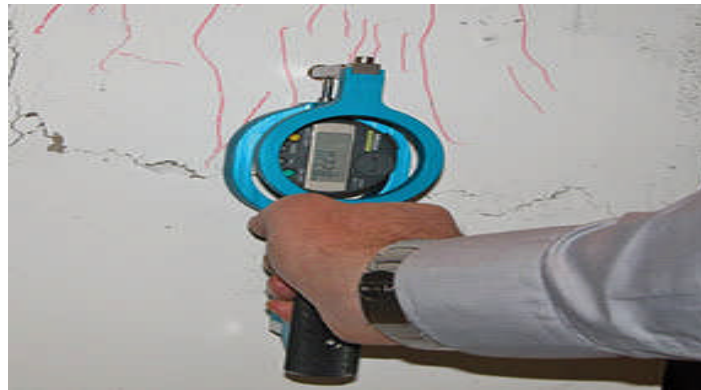
Figure 1.19 : Mesure d'évolution de la fissure avec le déformètre à bille.
