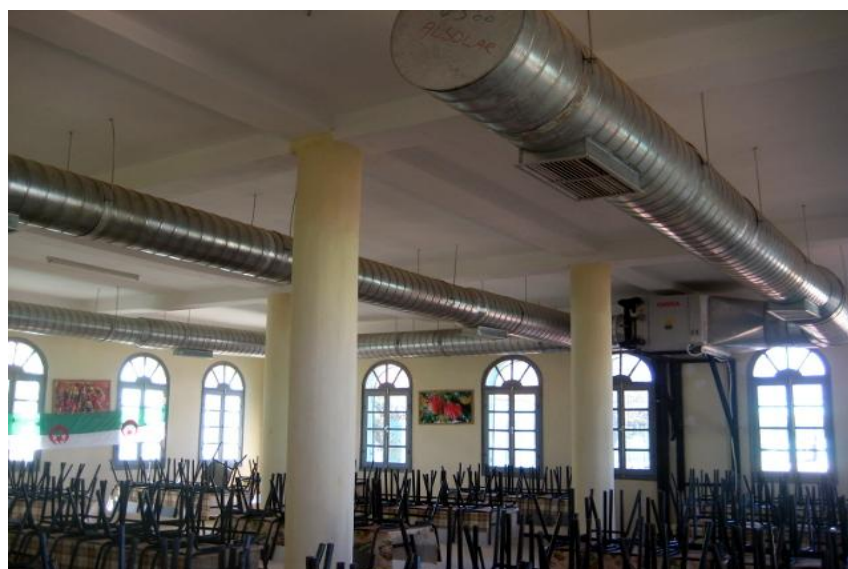
Figure I.5 Ecole primaire alimentée par climatisation géothermie [7].
