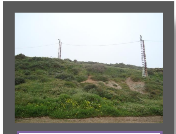
Figure 52: la ligne de moyenne tension
