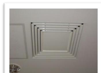
Figure 203: Illustration d'une bouche d'extraction
