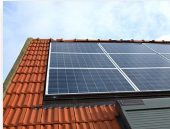
Capteurs solaires sur les toits
