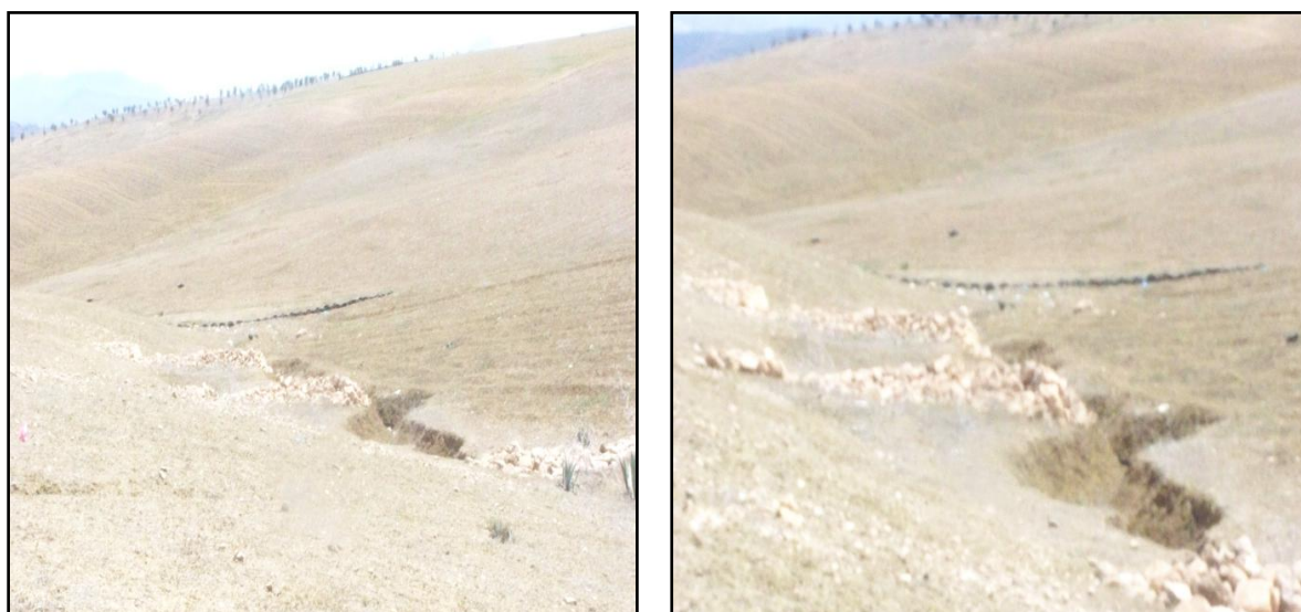
Figure N° 21 : Formation de Renard suite à un mauvais dimensionnement de la largeur du seuil (Mars 2011).
