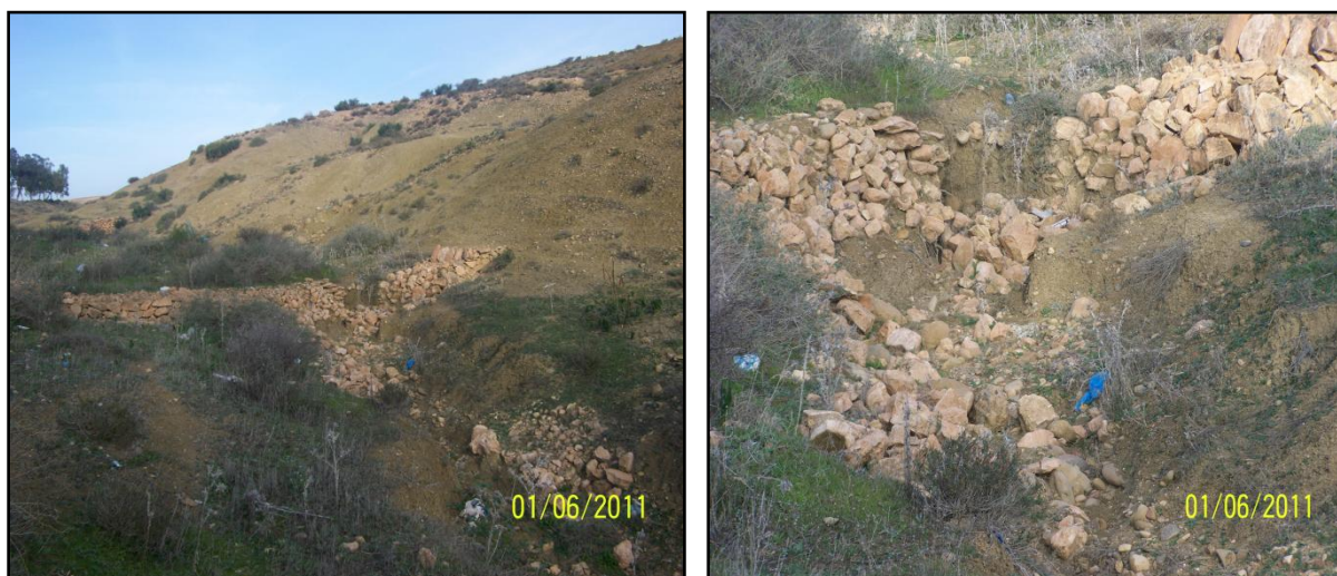
Figure N° 22 : Etat dégradé des seuils en pierre sèche.
