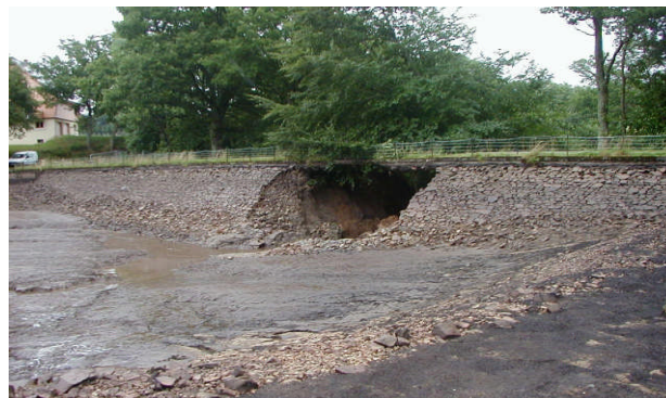
Figure 2.10 : Rupture par érosion interne le long de la conduite de vidange à SAIT-GERVAIS D'Auvergne le 15 janvier 2001 (poly-de-Dome) photo CEMAGREF Aix-en – provence
