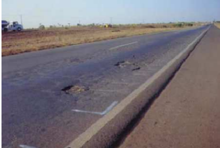
Endommagements sur une chaussée conventionnelle.
